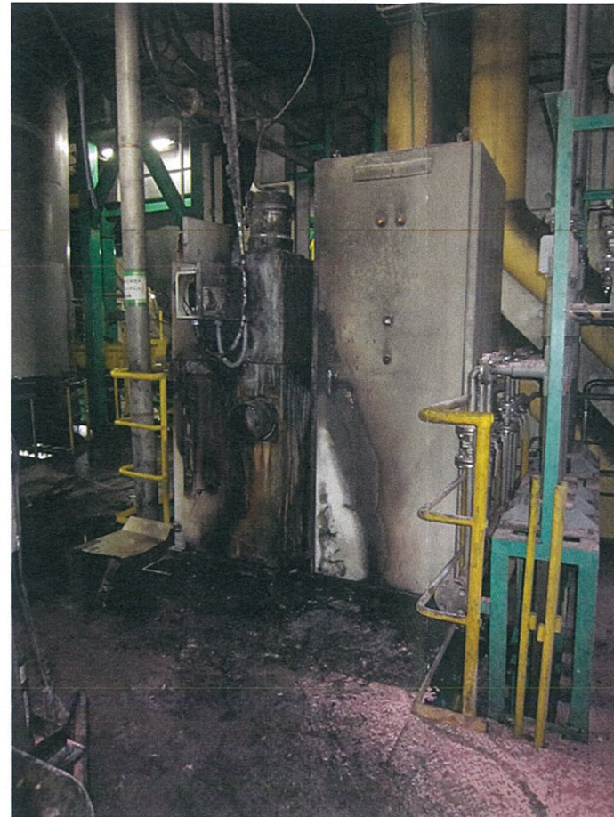
集塵器後部制御盤焼損
