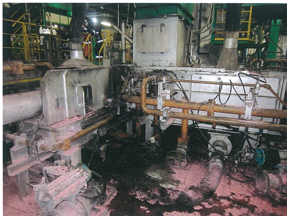
2A装入装置付近戻りごみホース焼損
