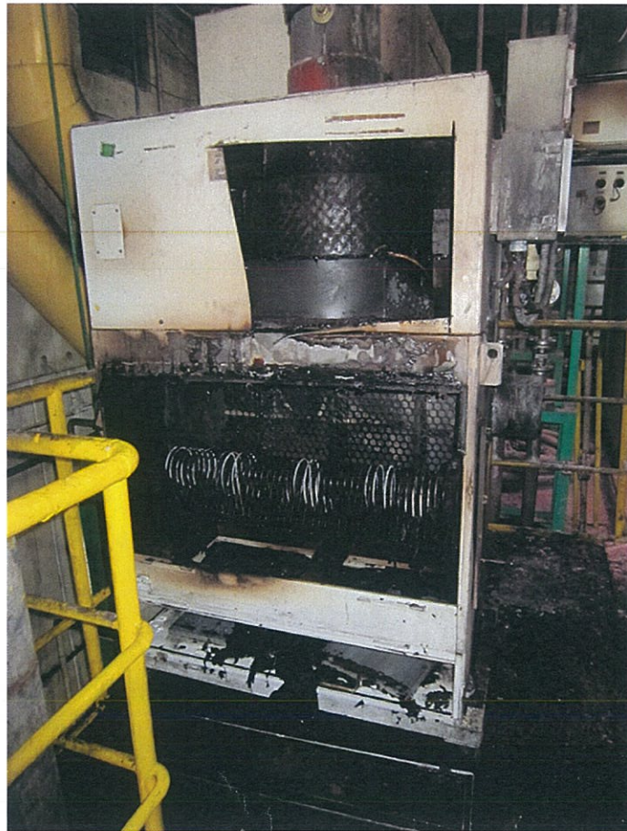
装入装置用集塵器焼損
